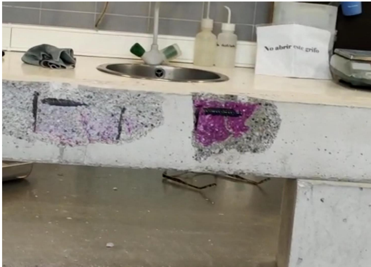
Reacción en una viga de hormigón armado
